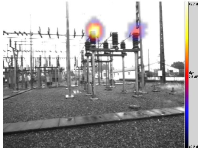
Detecção de descargas parciais em linha de alta tensão
