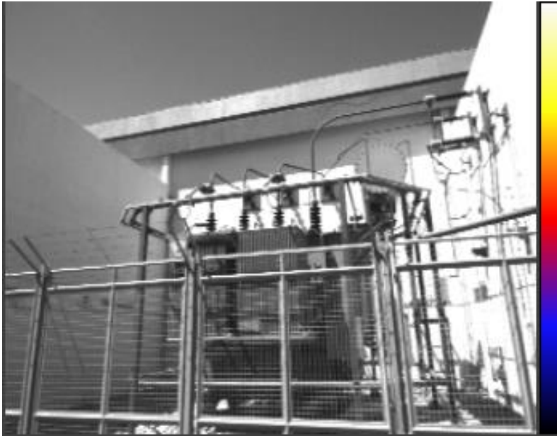
Transformador sem anomalia visível na imagem acústica. Baixa amplitude das gamas de frequência acima de 20 KHz
