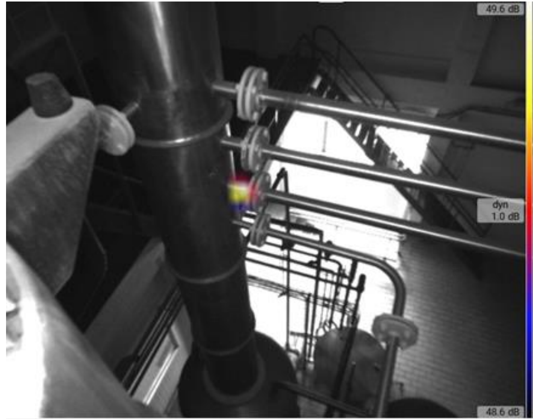
Fuga de vácuo em soldadura junto a flange
