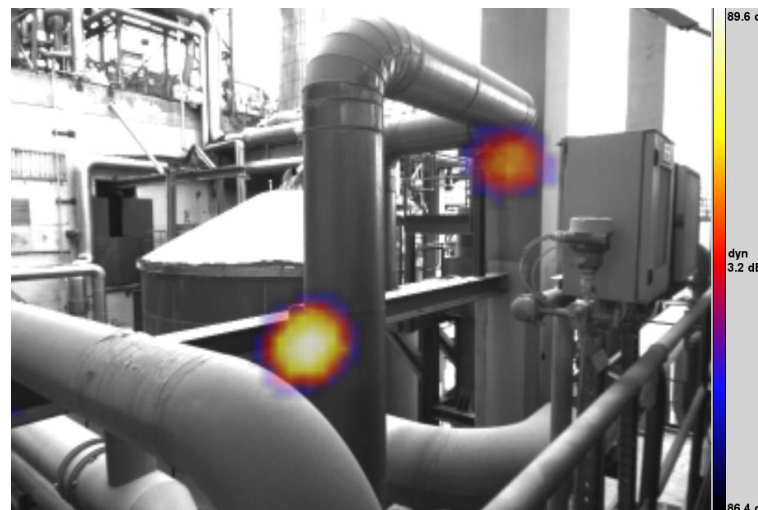
Transmissão sonora provocada por ligações rígidas entre as tubagens e a estrutura metálica de fixação
